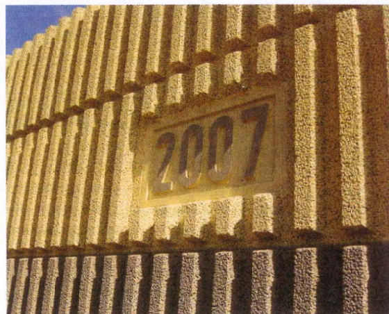
Abbildung 2: Profilierungen lassen sich auch in senkrechter Form gestalten. Zusätzliches Element ist bei diesem Beispiel das in die Struktur integrierte Baujahr
