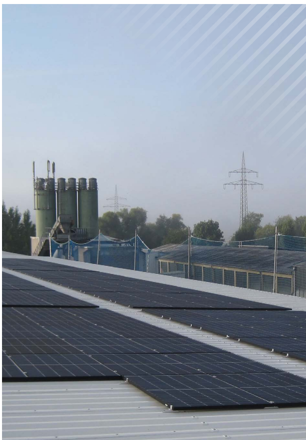
Bild: Photovoltaikanlage Fertigteilwerk Fulda
