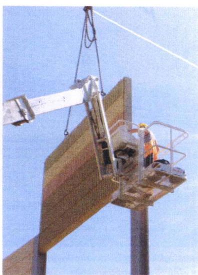
Abbildung 6: Zur Montage werden die einzelnen Betonelemente mit dem Kran an ihren Platz gehoben
