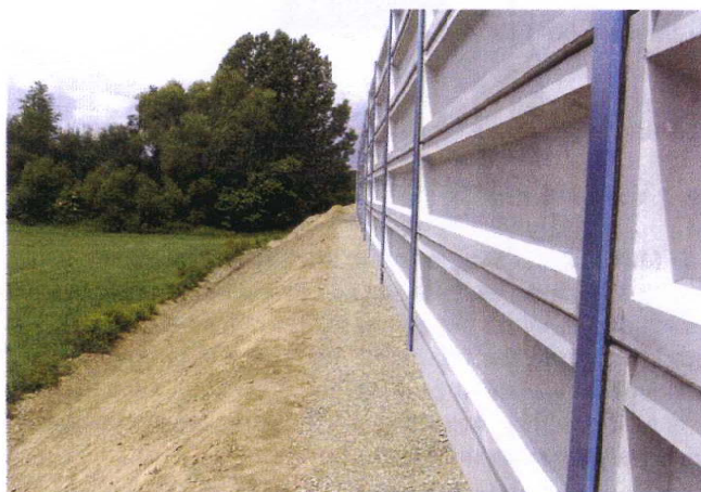
Abbildung 4: Die Befestigung der Schallschutzelemente erfolgt in der Regel an Pfeilern. Die einzelnen Elemente werden zwischen den Pfeilern montiert
