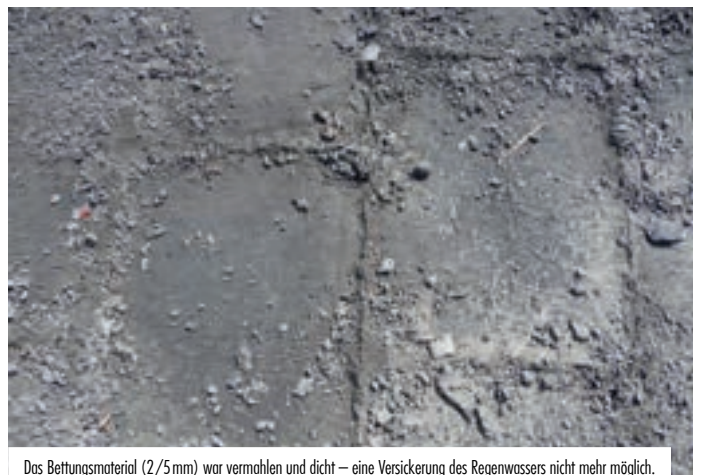
Das Bettungsmaterial (2/5mm) war vermahlen und dicht – eine Versickerung des Regenwassers nicht mehr möglich.
